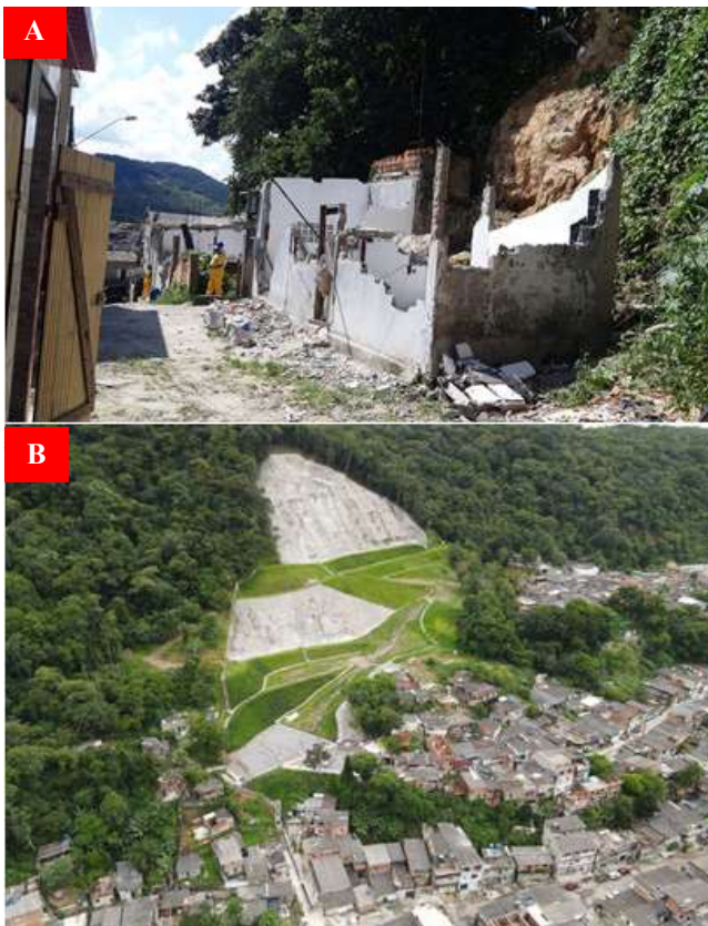
Figura 6. 6A: Demolições de moradias no Morro do Macaco Molhado. 6B: Obra de contenção no Morro do Macaco Molhado.
